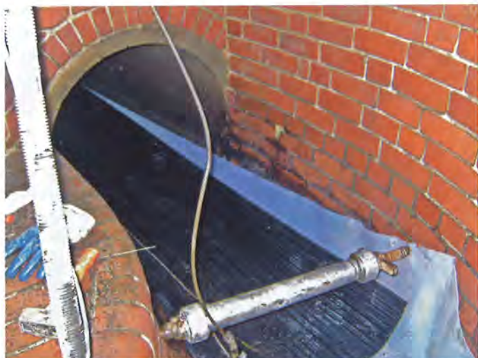
Blick auf die in den Abwasserkanal eingebauten Wärmetauscher von Brandenburger.
