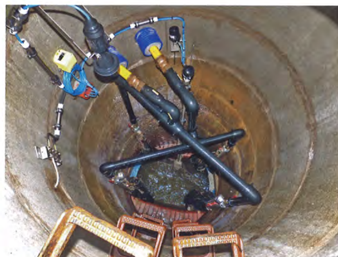
Blick in den Schacht mit Vor- und Rücklauf sowie den Messsensoren.
